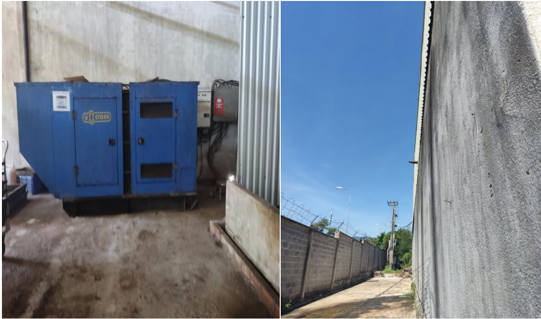
Hình 3.9. Khu vực đặt máy phát điện và ống thoát khí thải máy phát điện
