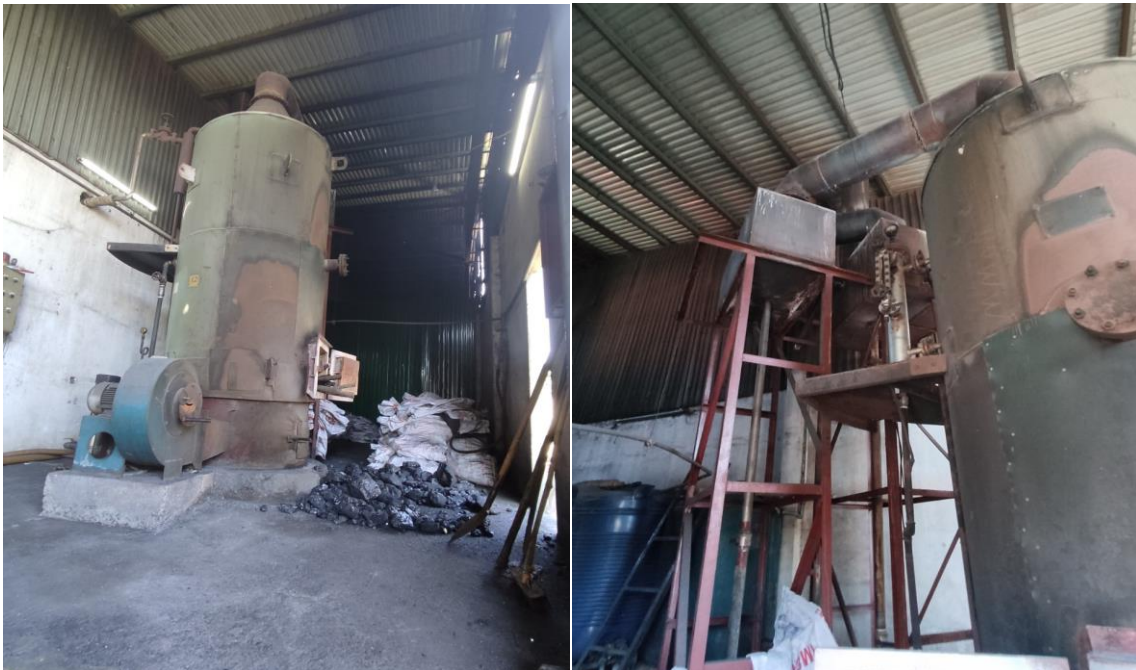
Hình 3.8. Lò hơi và các bể lọc bụi, khí thải
