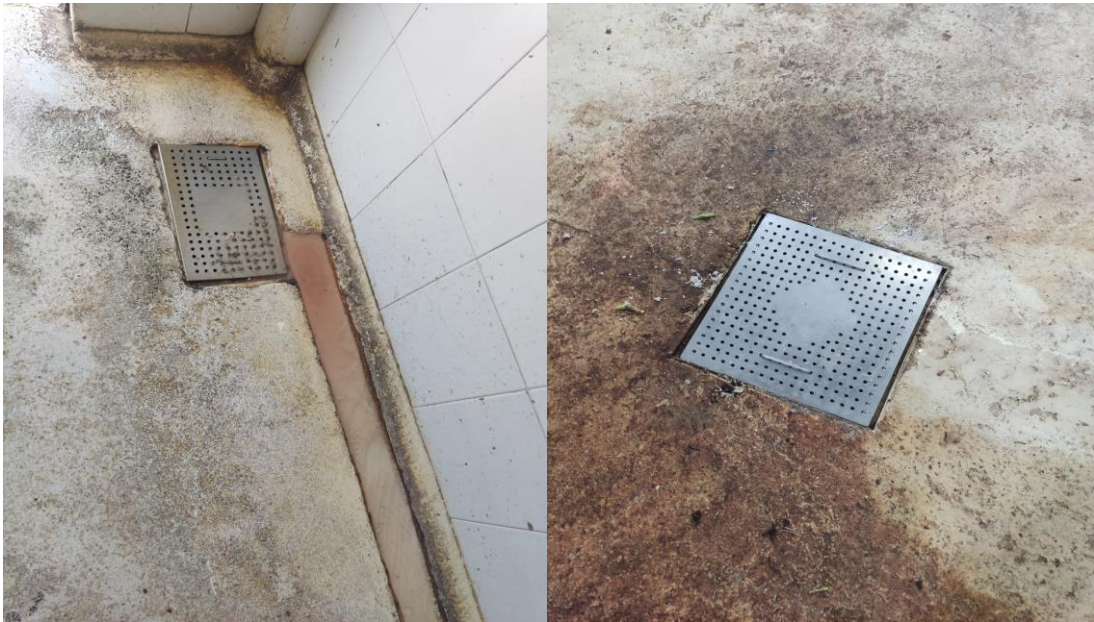
Hình 3.4. Hố ga thu gom tại các khu trong nhà xưởng
